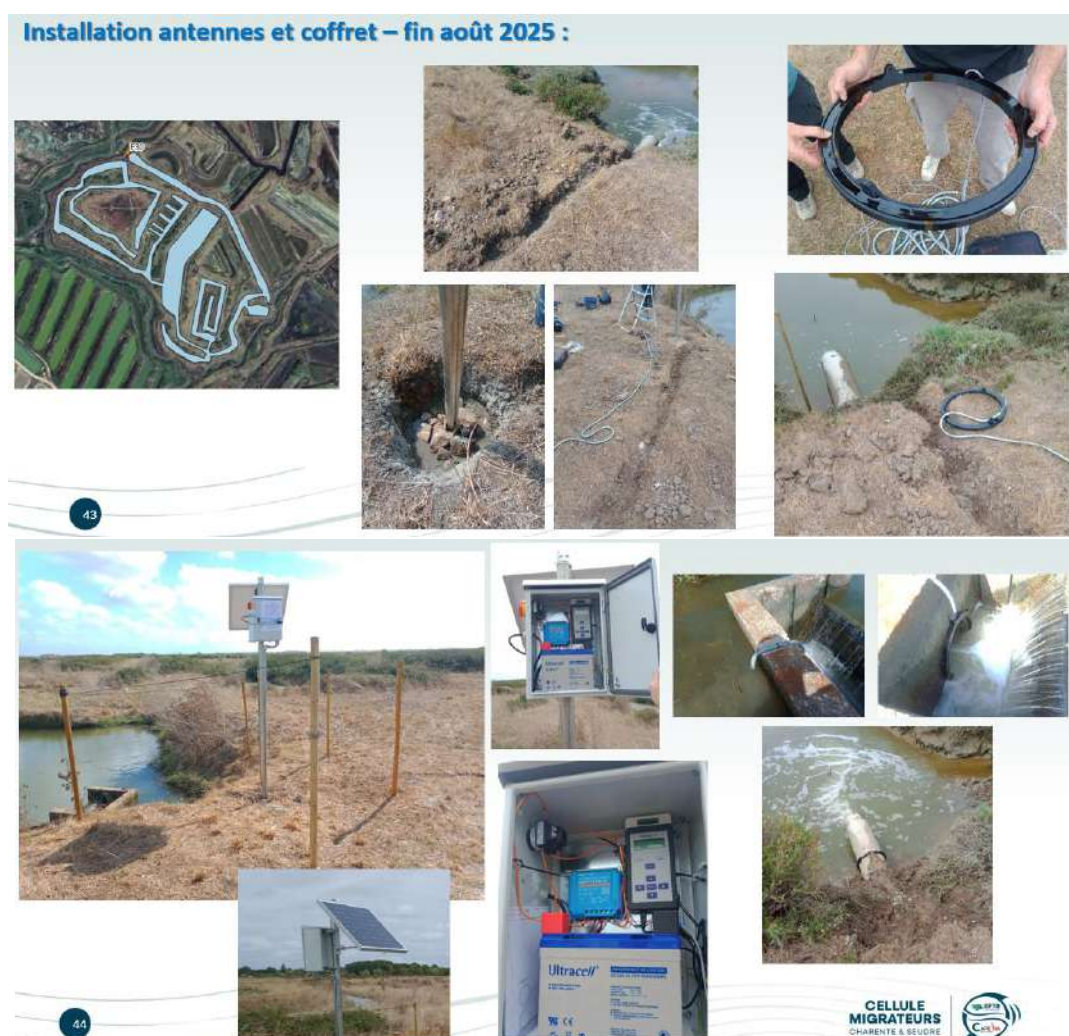
Figure 81: Photos de la mise en face du système de détection par télémétrie sur le site du F30
