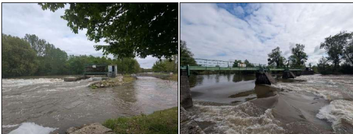
Figure 117 : Photos des ouvrages de Gademoulin à gauche et Bourg-Charente à droite
