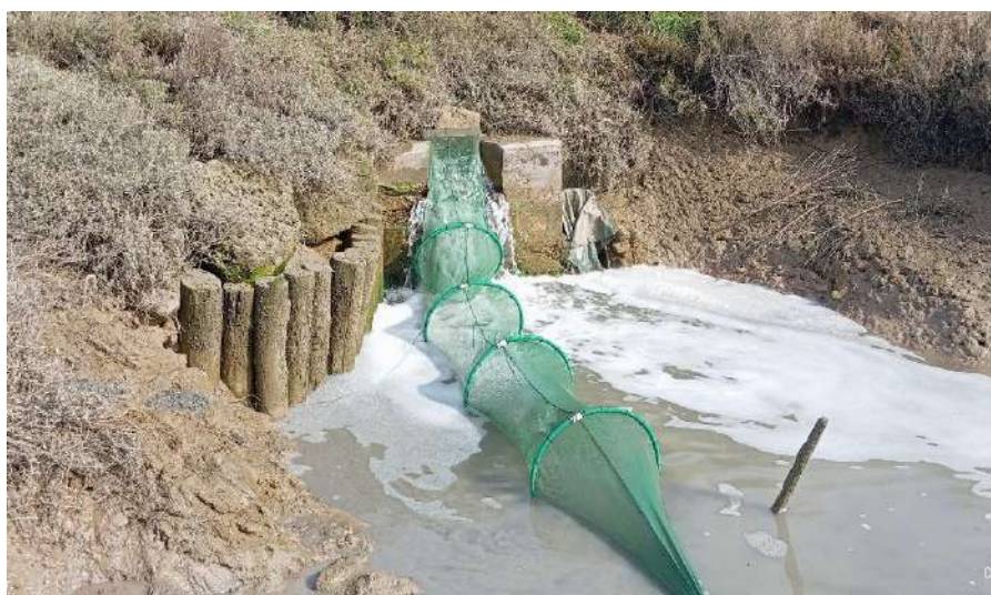
Figure 65: Chaussette de piégeage, avec empêches, placée sur la sortie d'un ouvrage (coté chenal)
