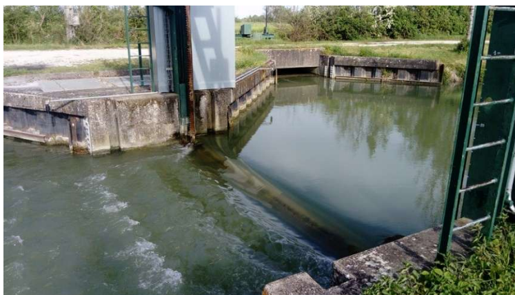
Figure 64 : Vanne de Suze baissée et surverse
